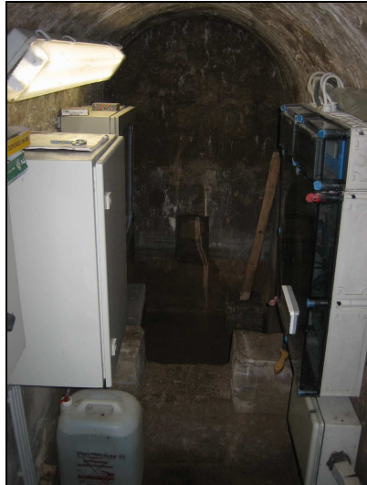
Im Nebenraum, in dem früher die Wasserfassung erfolgte, befindet sich heute die Elektrik und die Chemikalienbevorratung.
