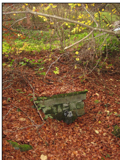
Der Quellüberlauf wird unterhalb der Straße über eine Froschklappe zum Girsterbaach hin abgeführt.
