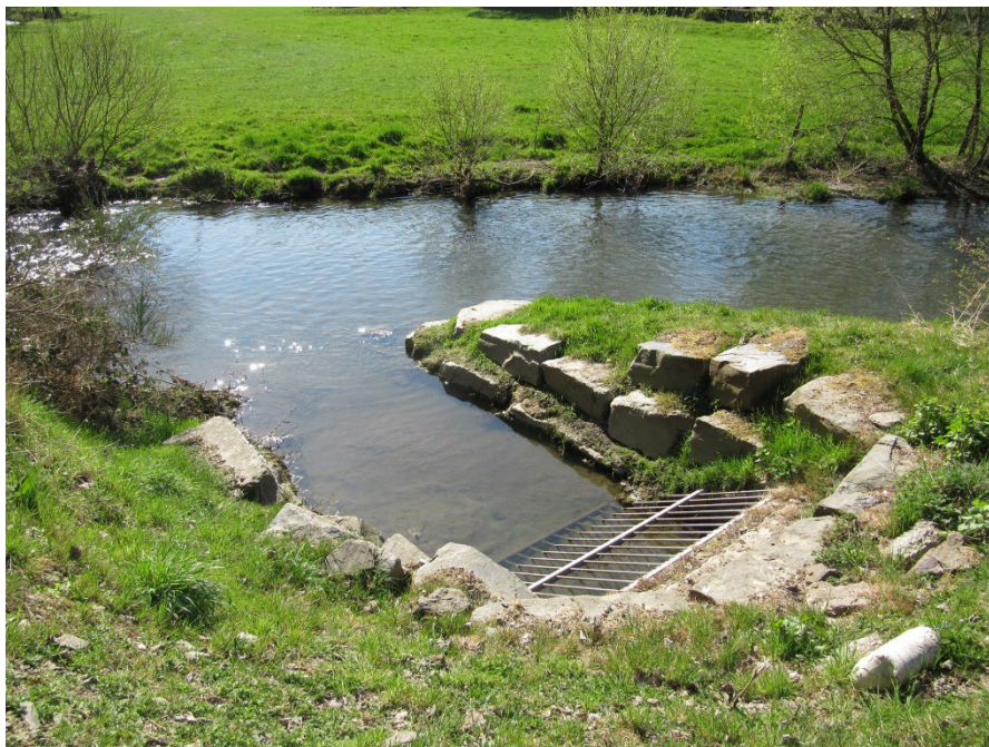
Einleitung in die Wiltz bei Bechel | Mögliche hydraulische Stoßbelastungen lassen sich durch eine lokale Profilaufweitung kompensieren.
