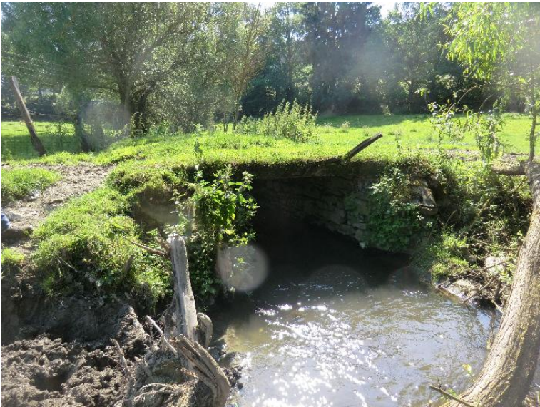
Durchlass; Ufer unterbrochen
