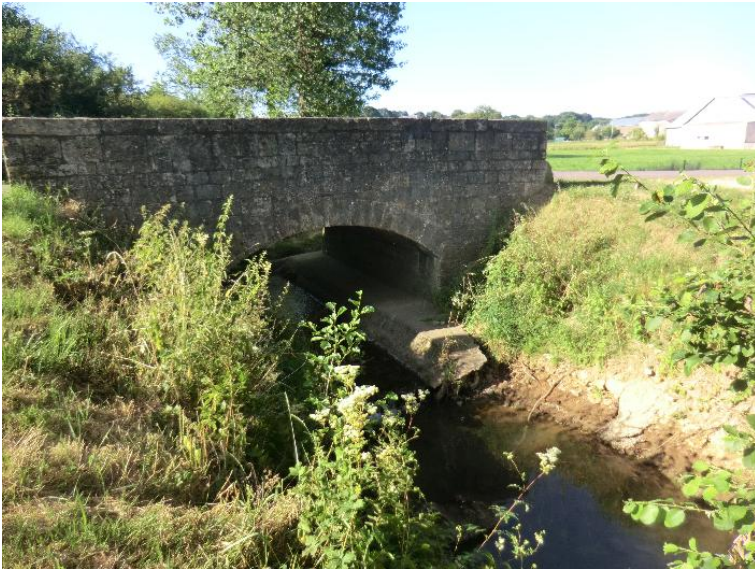
Durchlass; Ufer unterbrochen
