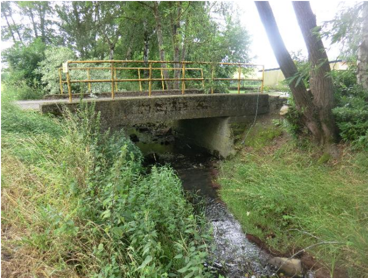
Durchlass; Ufer unterbrochen
