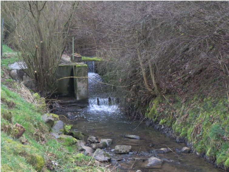
Glatte Gleite - Absturz; hoher
