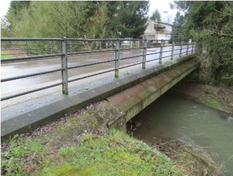
Durchlass; Ufer unterbrochen
