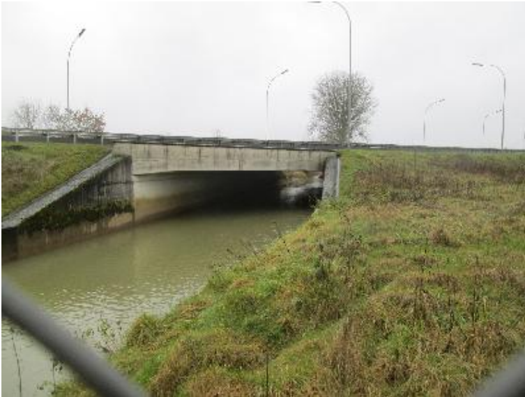
Durchlass; Ufer unterbrochen
