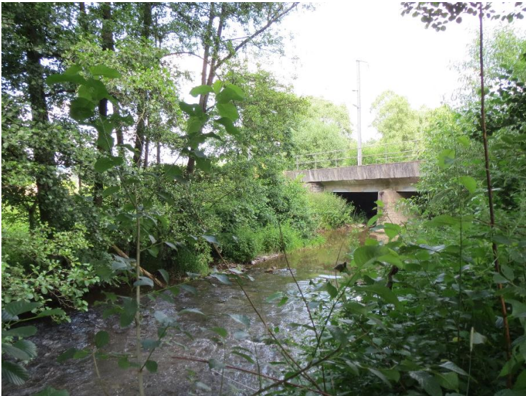
Durchlass; Ufer unterbrochen
