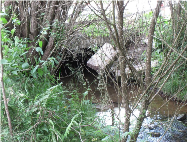
Durchlass; Ufer unterbrochen
