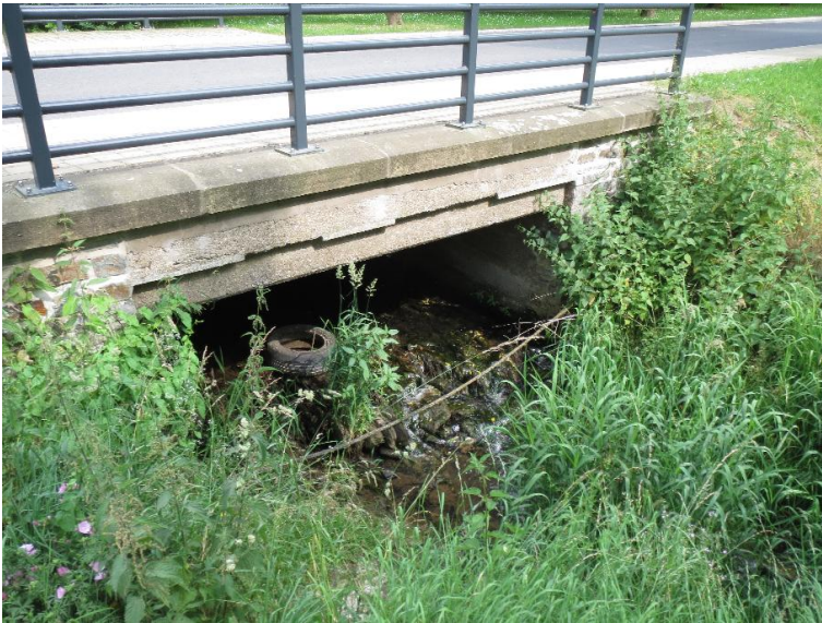
Durchlass; Ufer unterbrochen
