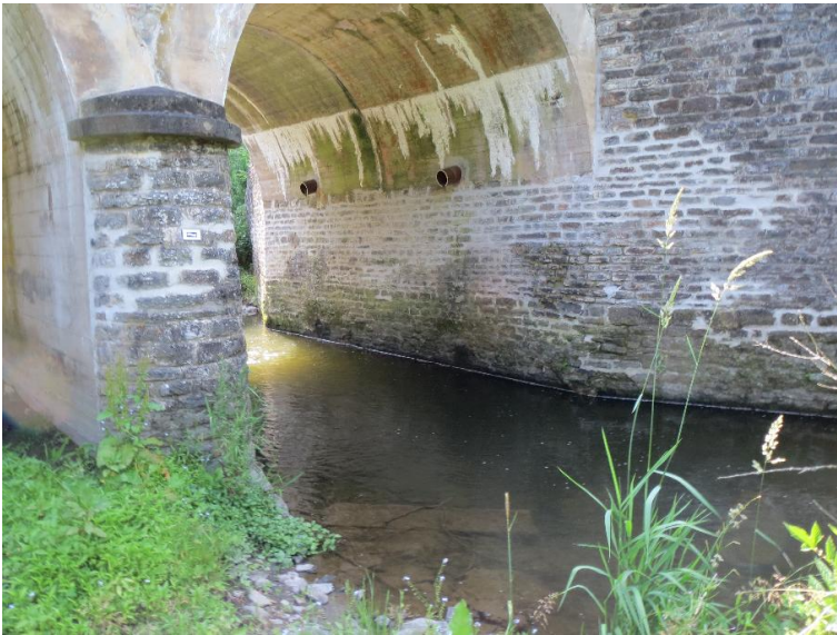
Durchlass; Ufer unterbrochen - Durchlass; Lauf verengt
