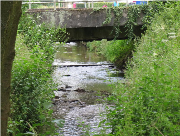
Durchlass; Ufer unterbrochen - Absturz; kleiner
