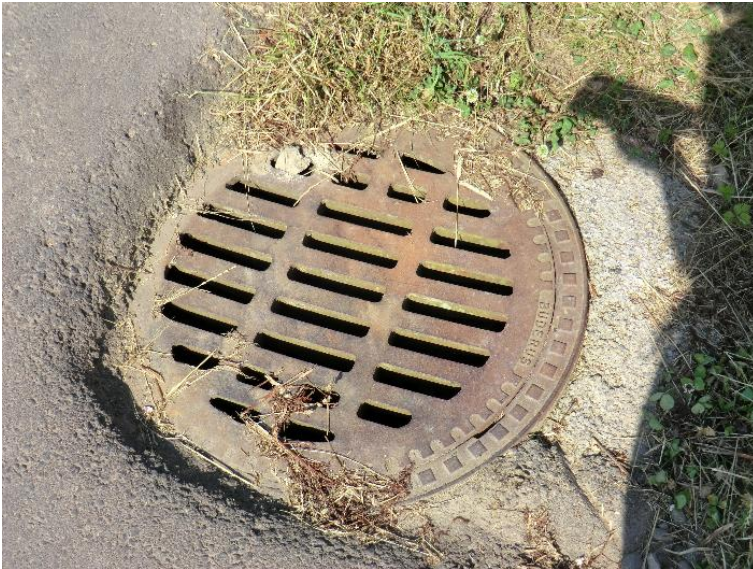
gulli deckel verrohrung
