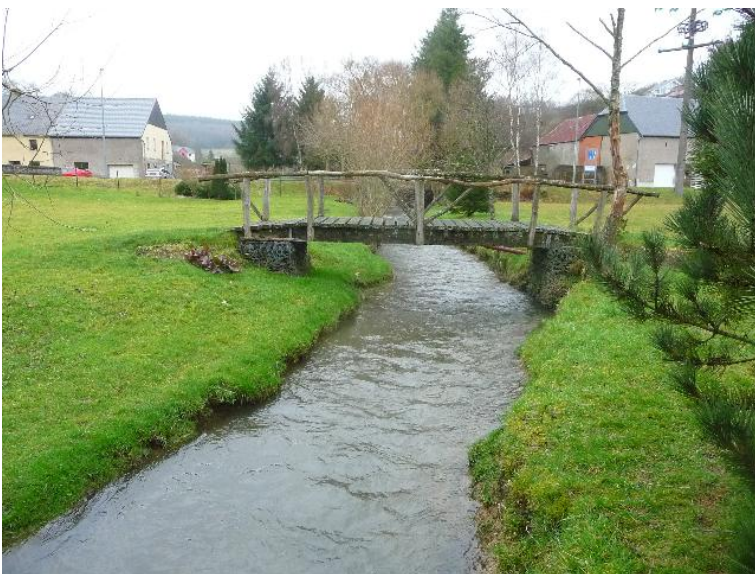
Durchlass; Ufer unterbrochen
