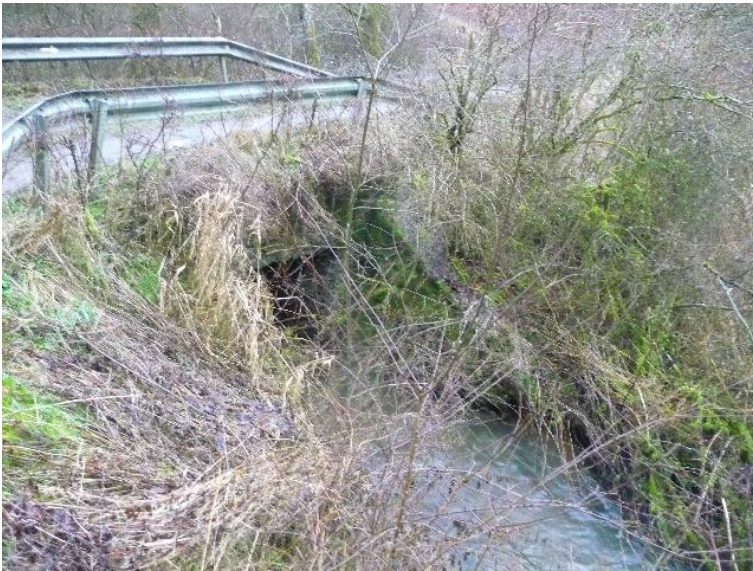
Durchlass; Lauf verengt
