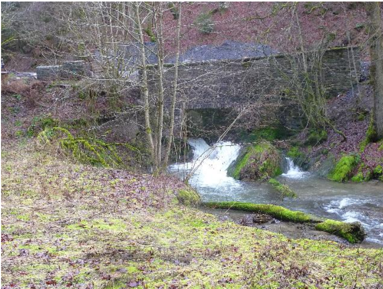
Durchlass; Ufer unterbrochen
