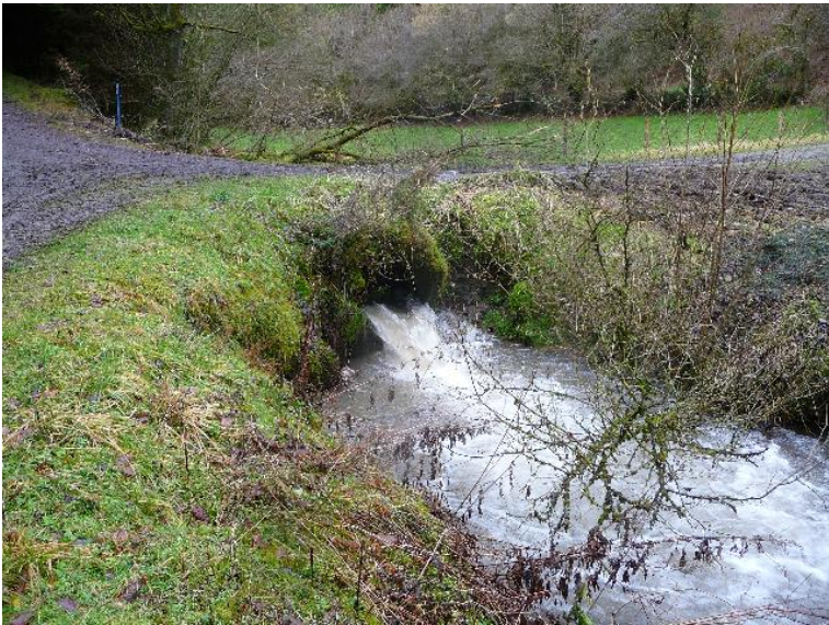
Durchlass; Ufer unterbrochen
