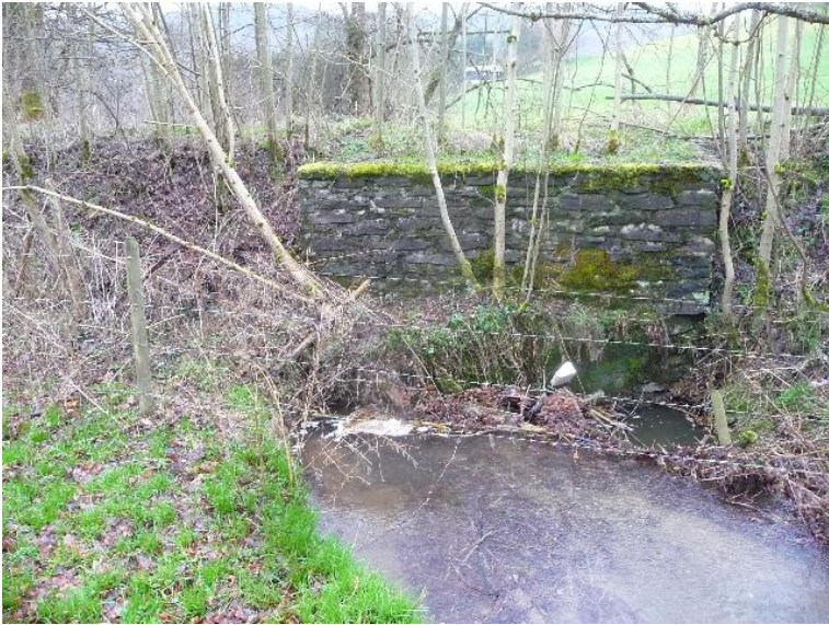
Durchlass; Lauf verengt
