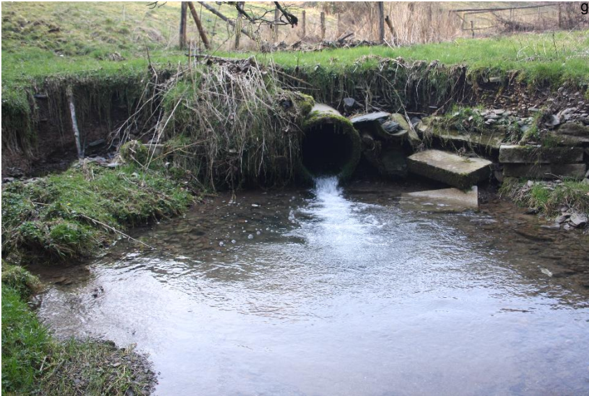
Absturz aus Verrohrung
