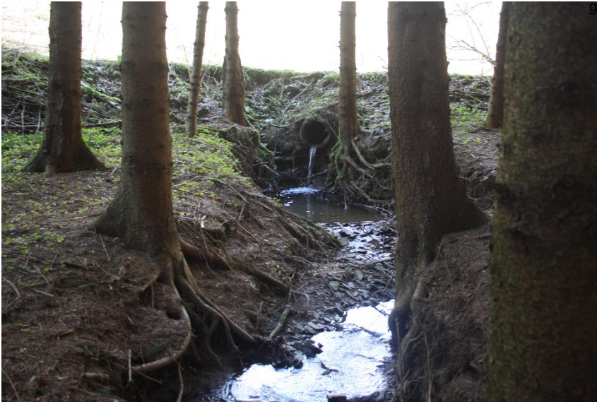
Absturz aus Verrohrung
