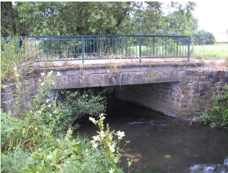
Durchlass; Ufer unterbrochen
