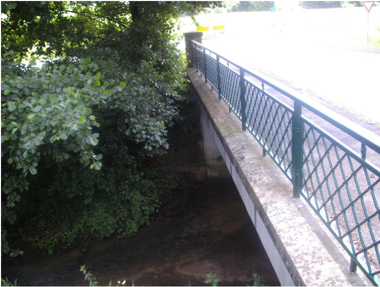
Durchlass; Ufer unterbrochen
