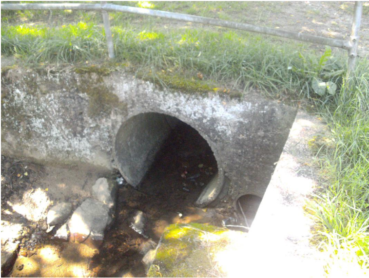
Durchlass; Lauf verengt
