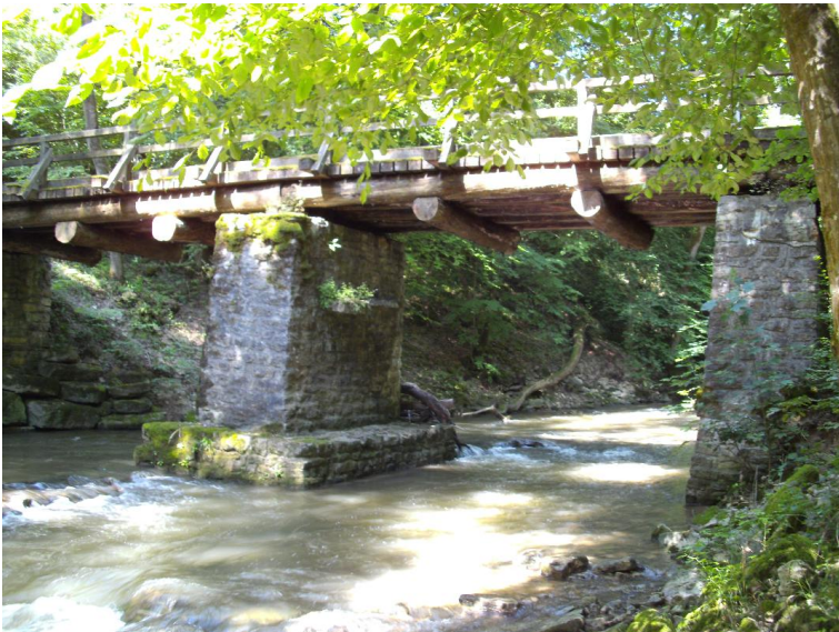
Durchlass; Lauf verengt
