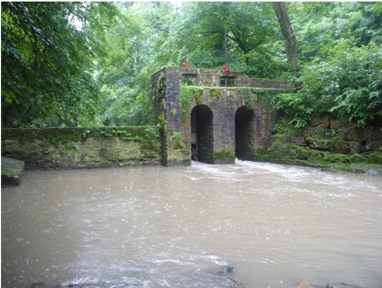
Durchlass; Lauf verengt
