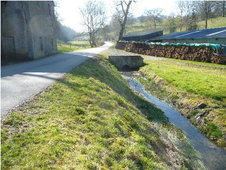
Durchlass; Lauf verengt
