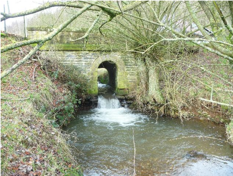
Durchlass; Lauf verengt
