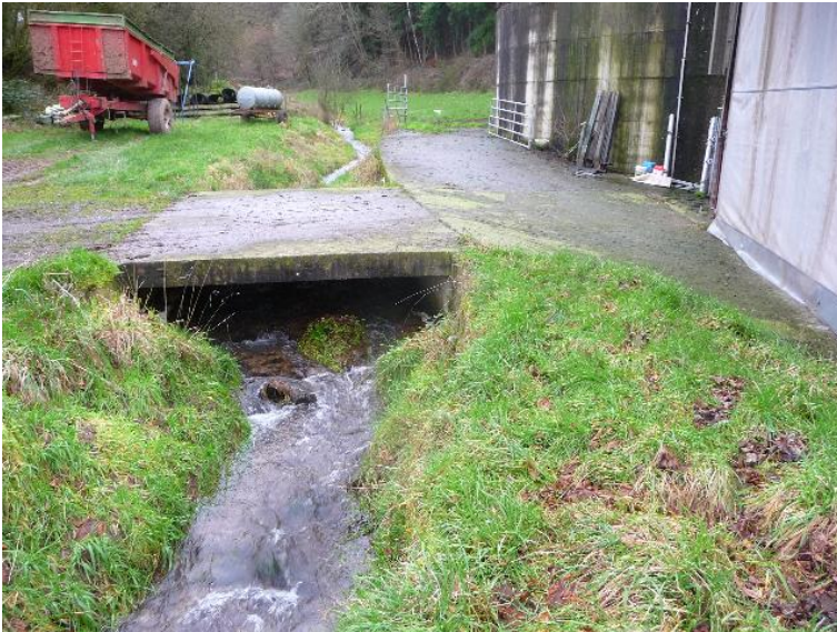
Durchlass; Ufer unterbrochen
