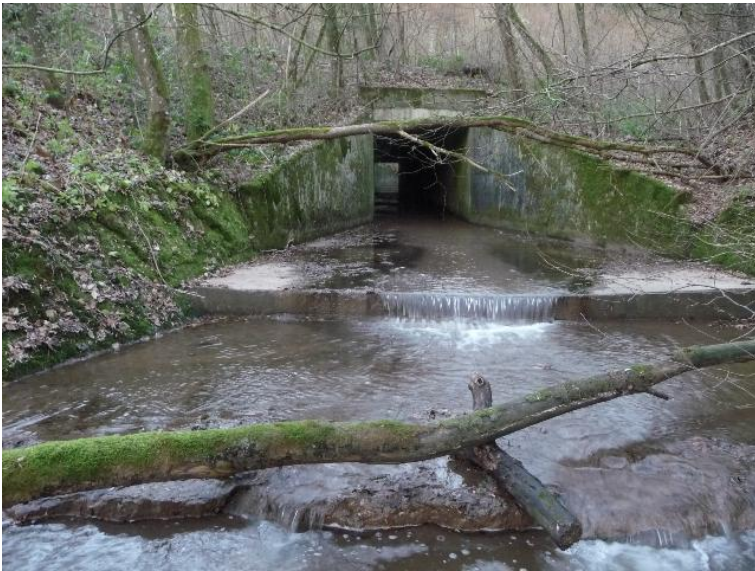
Durchlass; Ufer unterbrochen
