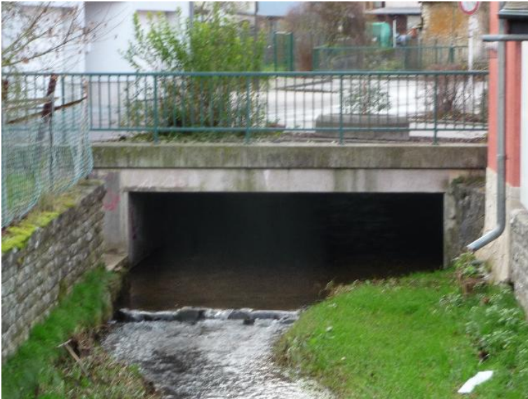
Durchlass; Ufer unterbrochen
