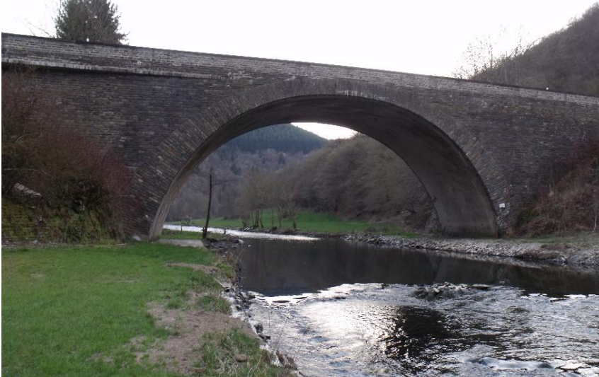
Durchlass; Ufer unterbrochen
