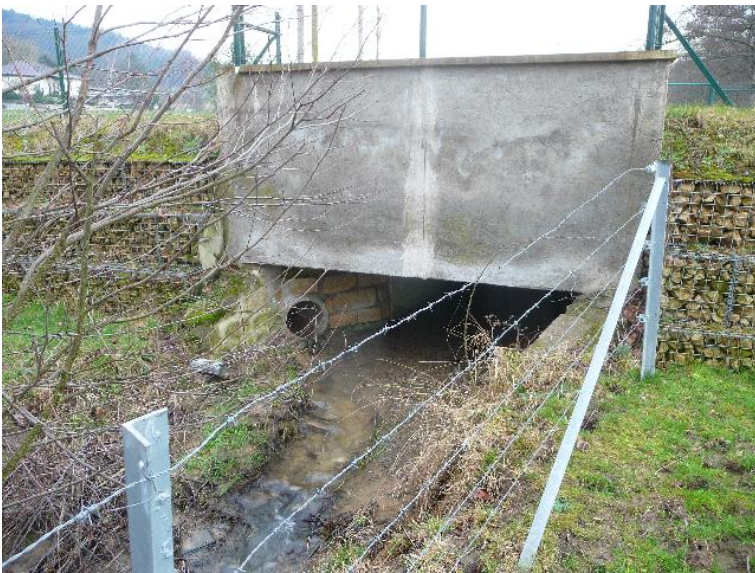
Durchlass; Ufer unterbrochen
