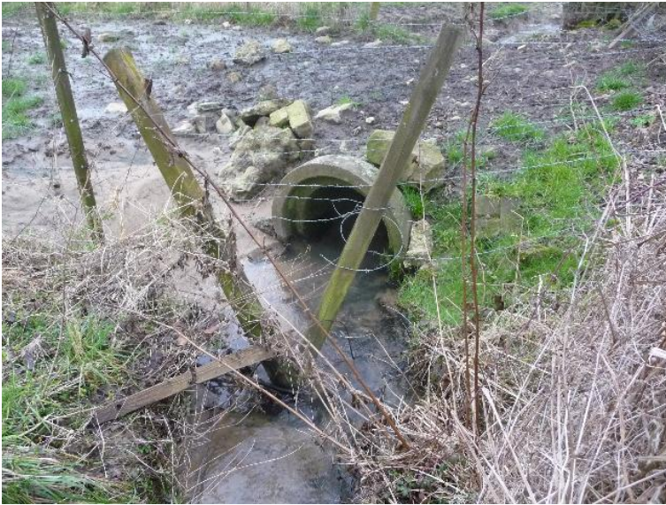
Durchlass; Ufer unterbrochen
