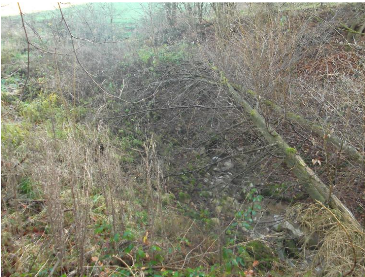
Durchlass; Lauf verengt
