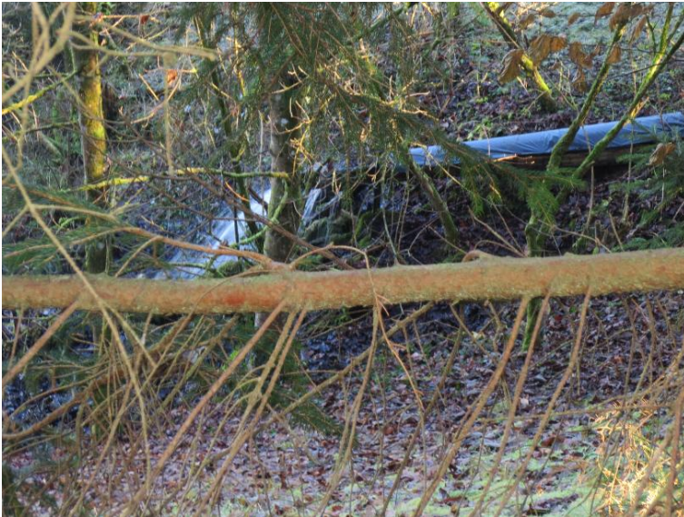
Absturz aus Verrohrung
