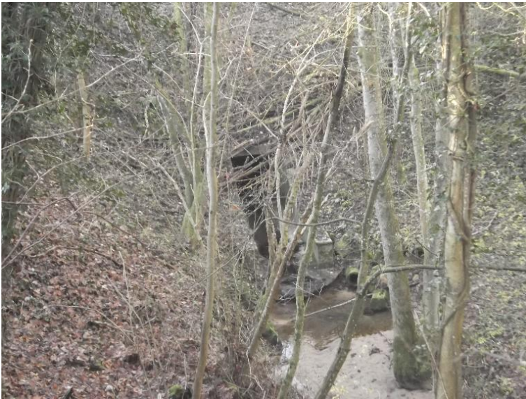
Durchlass; Lauf verengt
