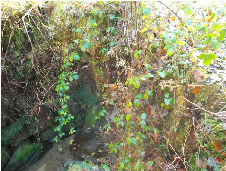
Durchlass; Lauf verengt
