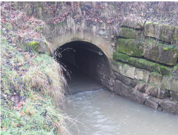
Durchlass; Lauf verengt
