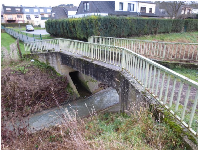
Durchlass; Lauf verengt
