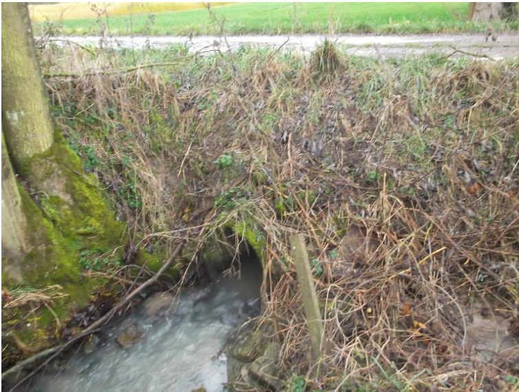
Durchlass; Lauf verengt
