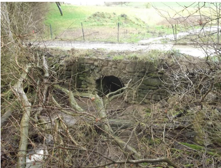
Durchlass; Lauf verengt
