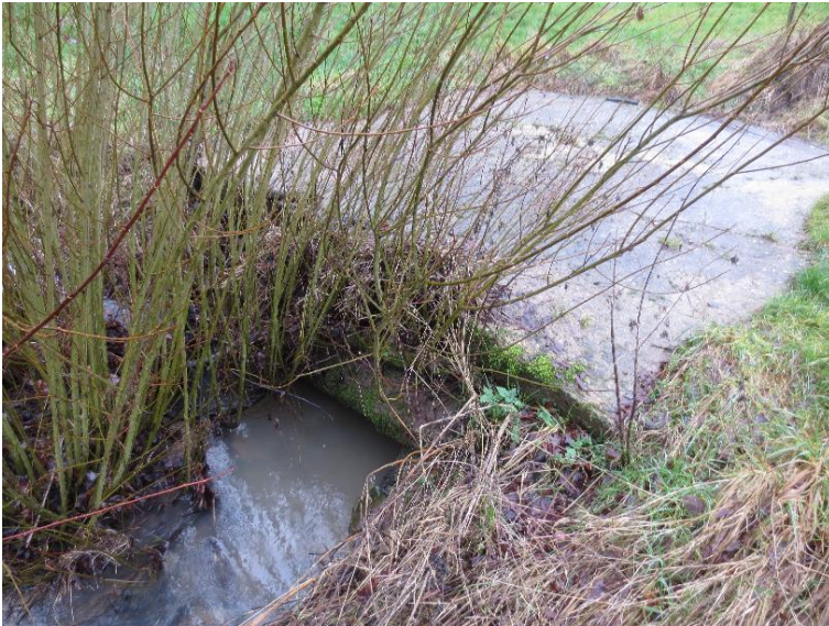
Durchlass; Ufer unterbrochen
