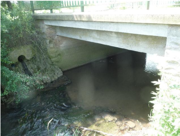
Durchlass; Ufer unterbrochen
