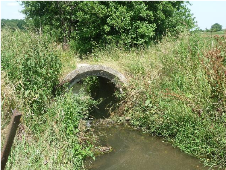
Durchlass; Lauf verengt
