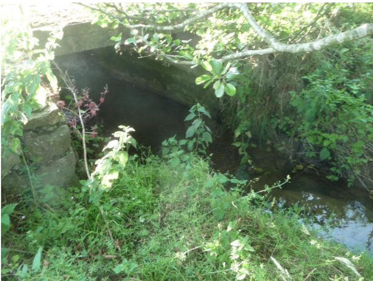
Durchlass; Ufer unterbrochen
