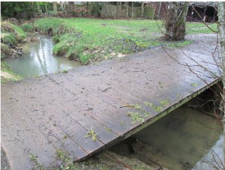
Durchlass; nicht strukturschädlich
