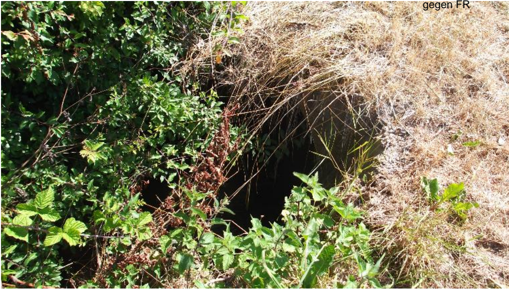
Durchlass; Lauf verengt
