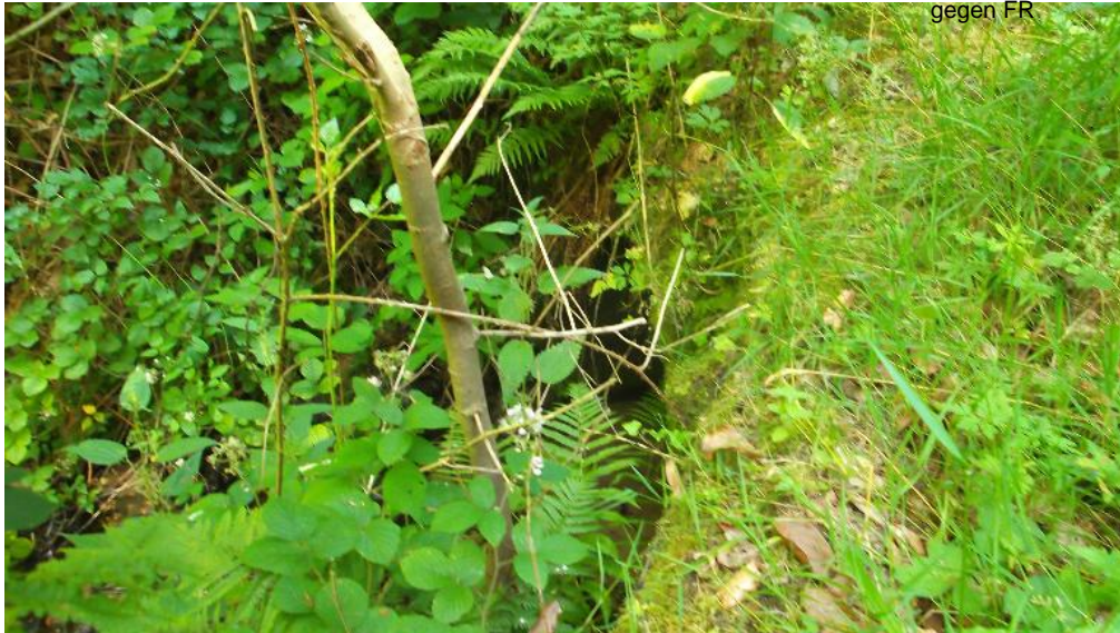
Durchlass; Lauf verengt
