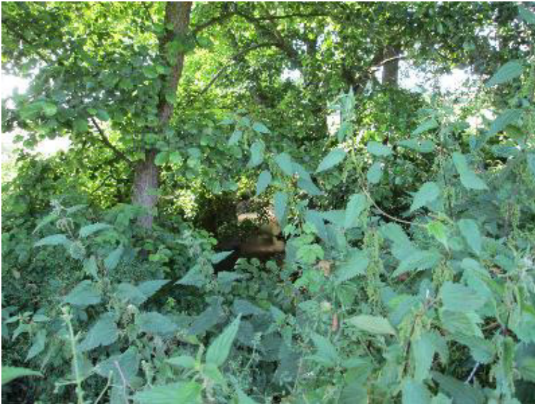
Durchlass; Ufer unterbrochen
